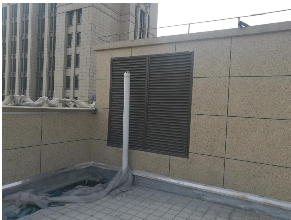
门急诊楼 P1 排气口
