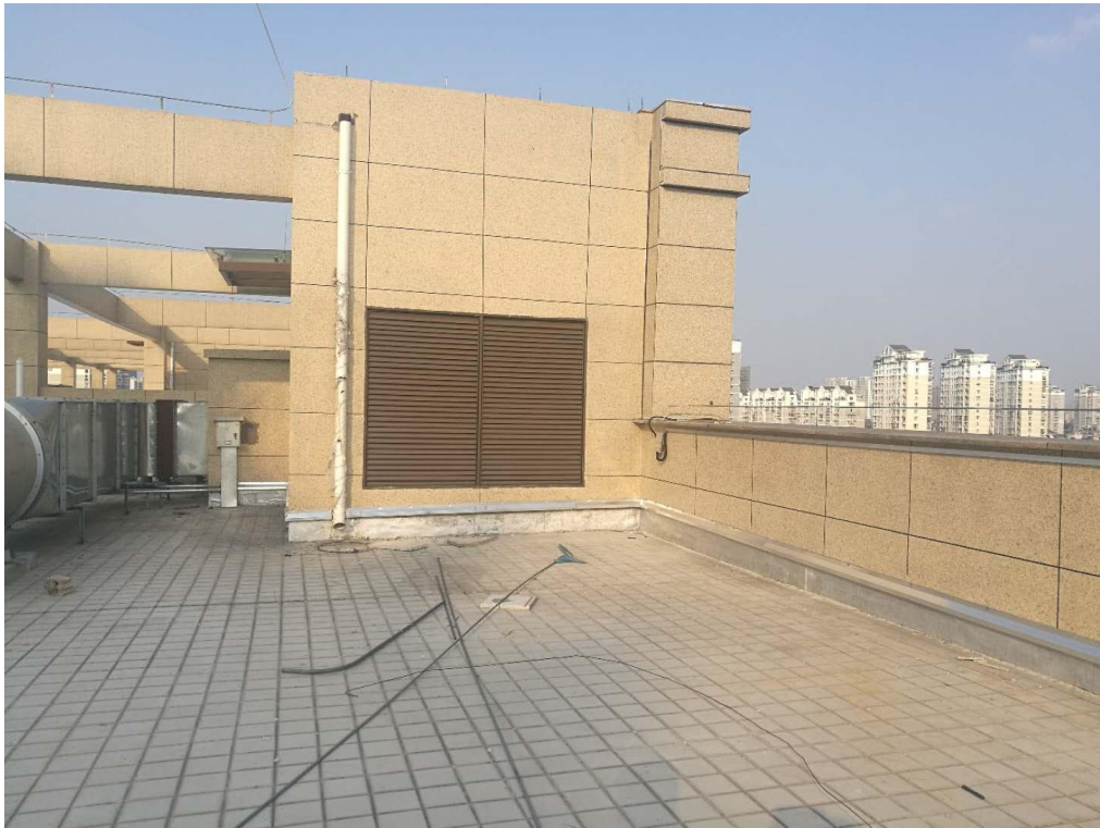
门 急 诊 楼 P2 排 气 口
