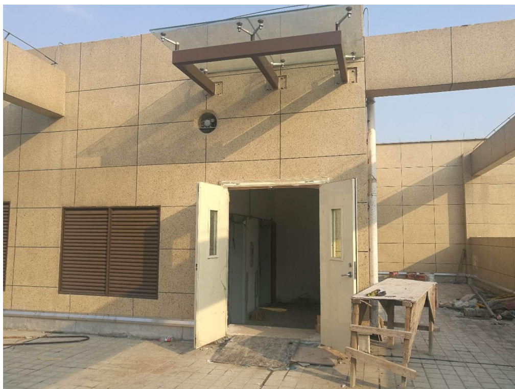
门急诊楼 P4 排气口
