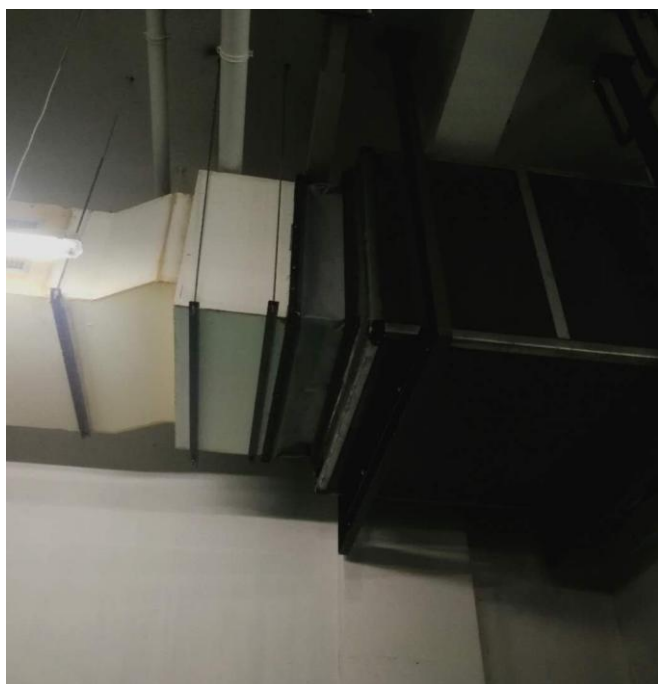
风机减振吊钩、软连接及消声器
