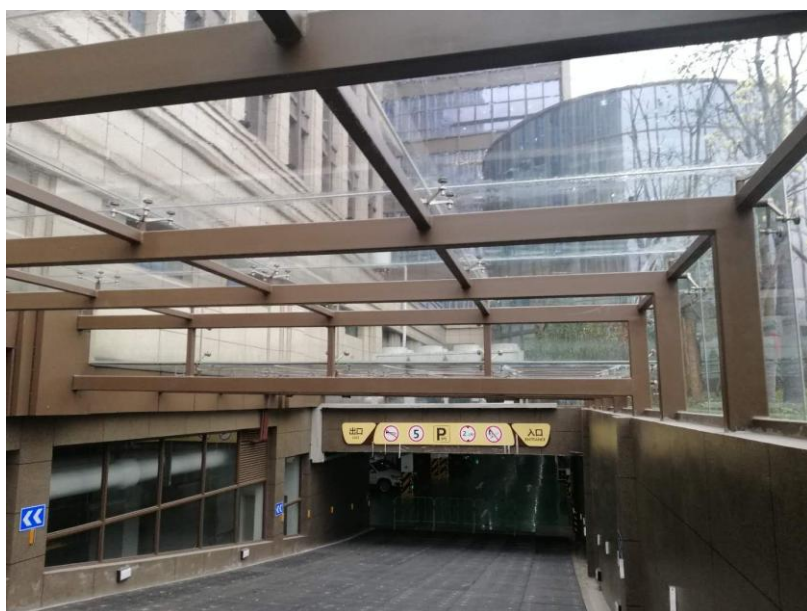
住院 楼南 侧出 入口 隔声 顶棚
